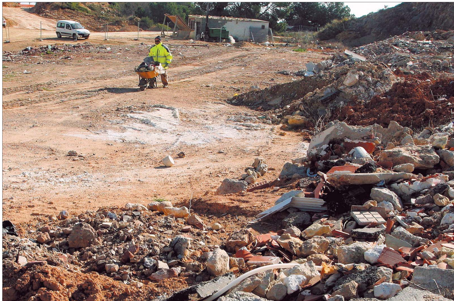
Terrenos de la empresa Control de Runes SA, en La Budallera (Tarragona) destinados al recepcionado y selección de residuos. FOTO: LLUÍS MILIÁN
